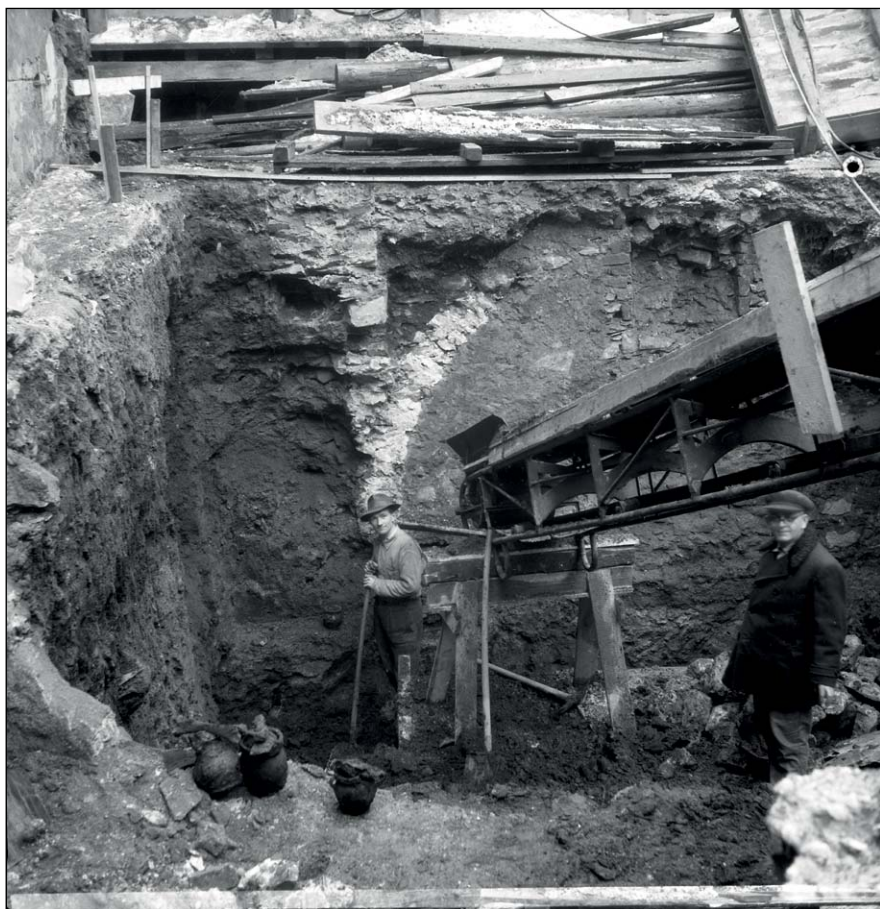
Obr. 4. Olomouc, Ztracená ulice č. 27. Fotografie zachycující bourání domu roku 1955. Vpravo stojící je archeolog Josef Skutil. Digitalizace: P. Rozsival.
