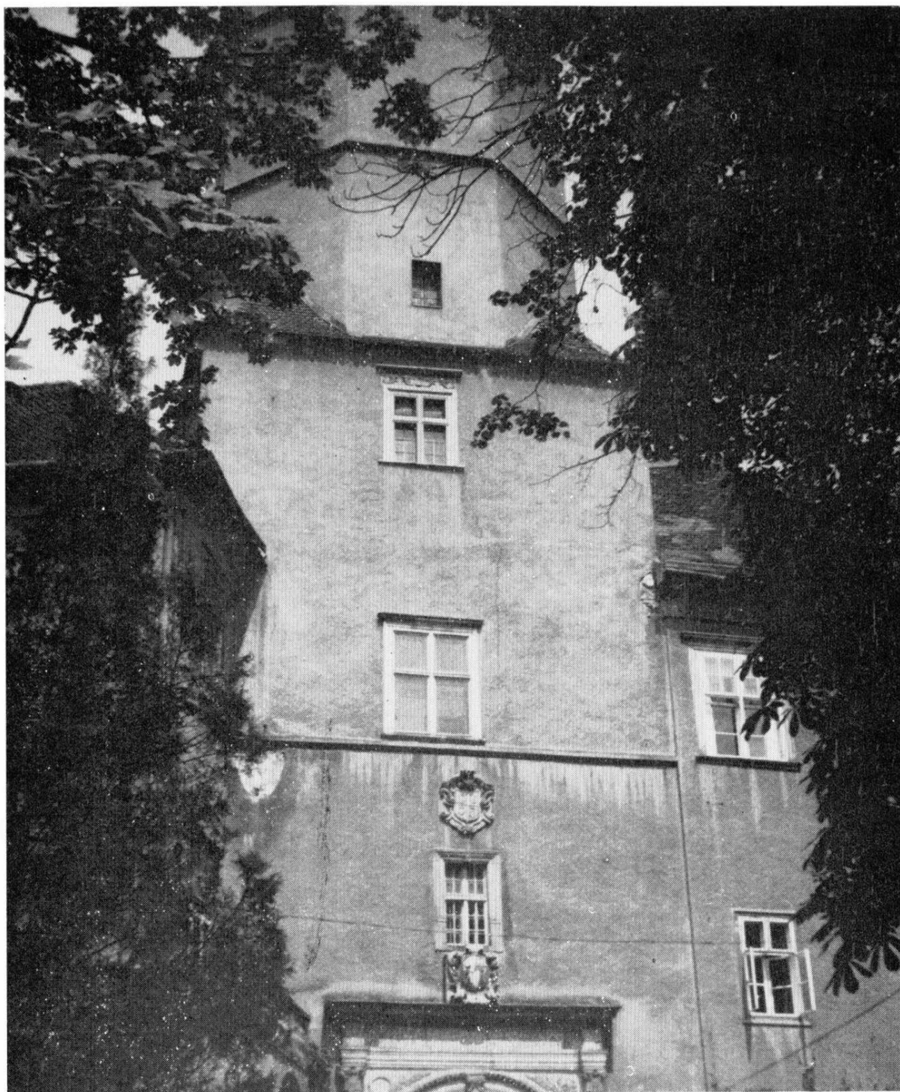
Tovačov, zámek. Střední část průčelí zámecké věže. Stav v červnu 1972. Snímek I. Hlobil.
