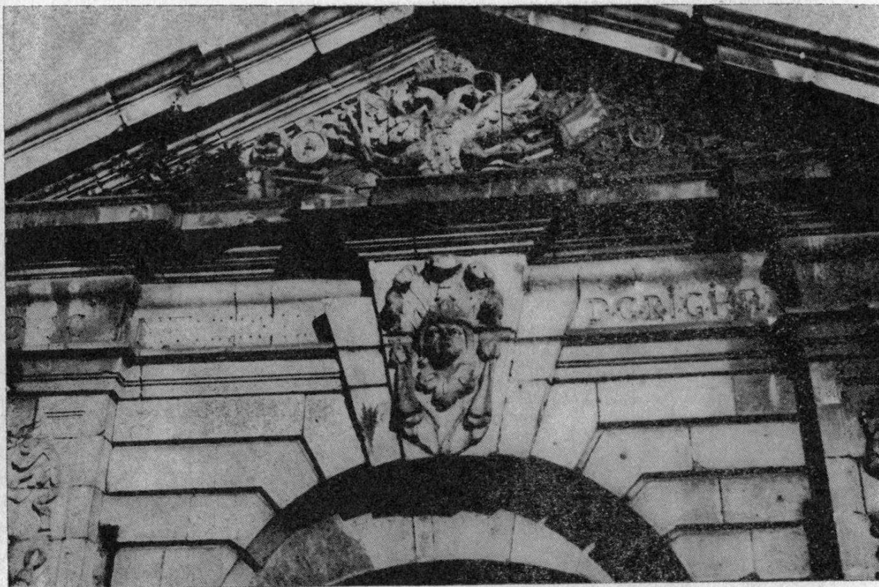
Reliéfy ve štítu a na klenáku nad hlavním vstupem do Terezké brány. Stav r. 1951.
