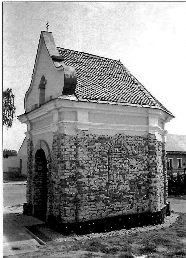
Kaple sv. Jana Nepomuckého na Novém Světě před opravou. Foto autor.
